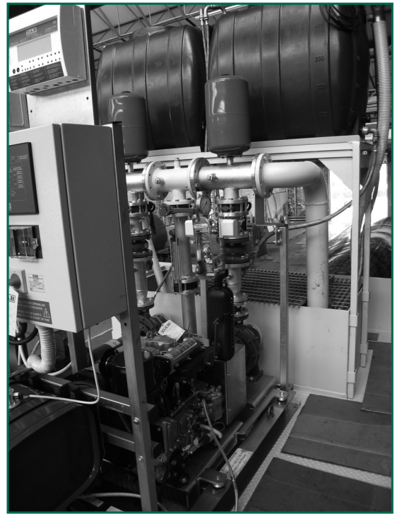
Vano pompe con gruppo antincendio montato.
